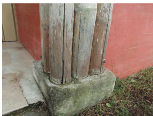
Figura 31. Pudrición por humedad
