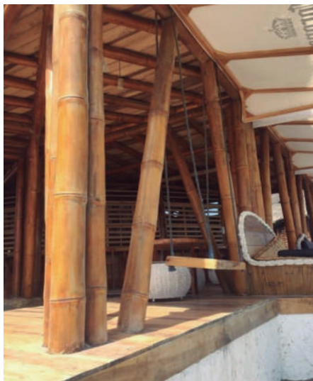
Figura 20. Estructura que presenta decoloración de los culmos
