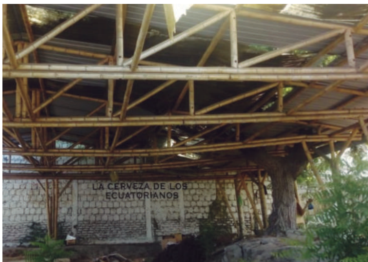
Figura 24. Estructura que presenta deformaciones estructurales
