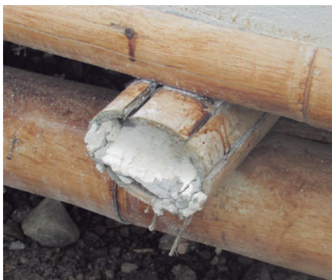
Figura 33. Aplastamiento de piezas estructurales Fuente: INBAR, 2021
