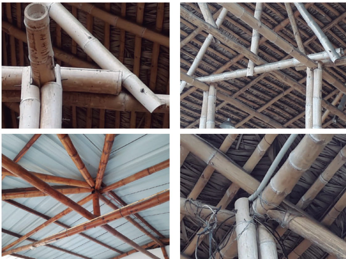
Figura 36. Uniones mal ejecutadas
